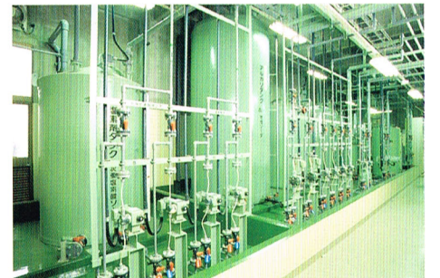
●薬品タンクヤード
