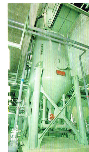
●活性炭吸着塔
