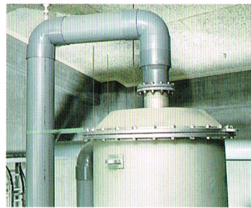
●オーバーフローシャフト上部
