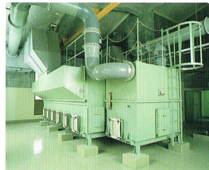
●中・低濃度活性炭脱臭塔
