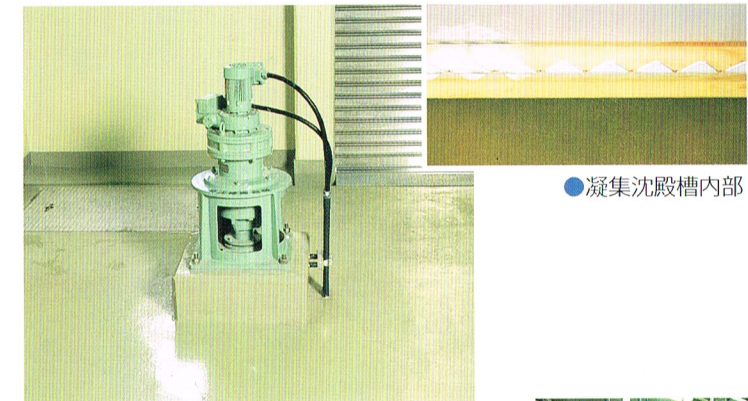
●凝集沈殿槽・凝沈汚泥掻き機
