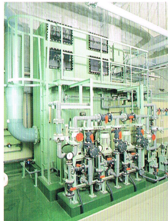
●酸・アルカリ脱臭塔
